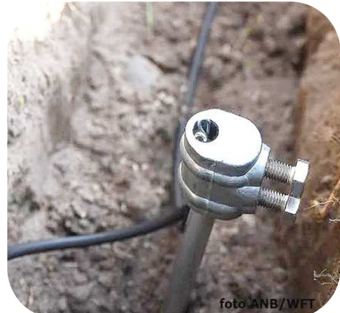
Het aansluiten van een aarding kan niet met een geleider met zwarte isolatie, hier toont het WFT, wars van kennis, een inbreuk op het AREI
