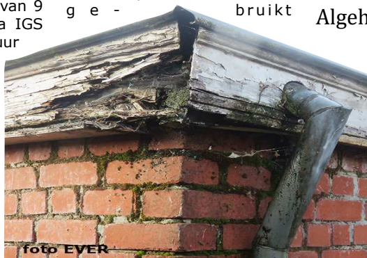
Dit pand wordt door SVK Meetjesland verhuurd, deze onderneemt niets om te herstellen, zelfs de oorzaak, ontbreken van bolbladrooster, wordt niet aangepakt. Het pand kreeg in juli 19 wel een conformiteitsattest.
