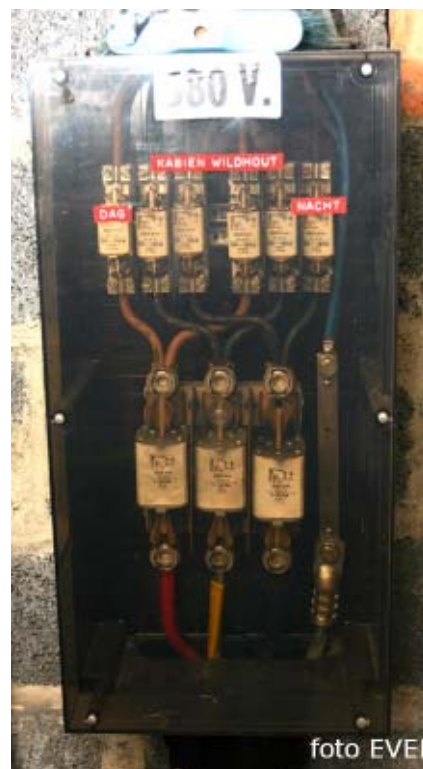
6 Appartementen, +/- 16 kW verbruik per appartement, beveiligd met 200A!
