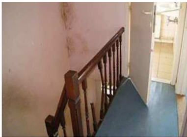
vocht met schimmelvorming op binnenmuur
